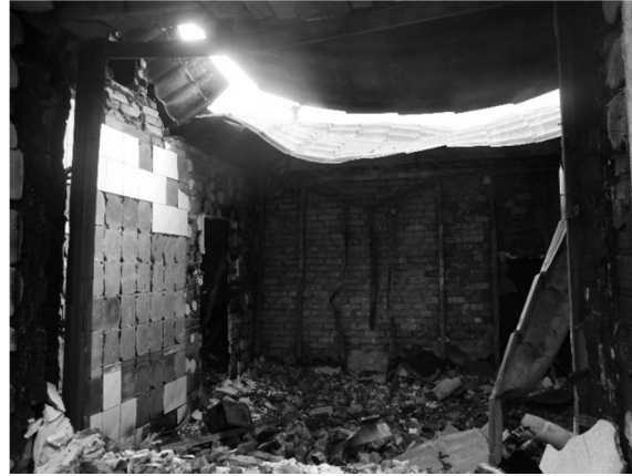
Рисунок 3 – Порівняння пошкоджень кладки залежно від виду внутрішнього опорядження
