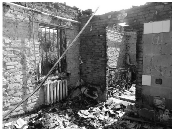
Рисунок 4 – Порівняння ступеня пошкодження кладки залежно від розташування та товщини стін (перегородок)
