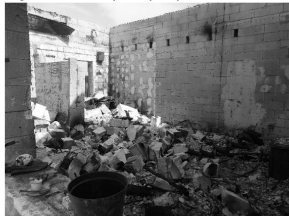
Рисунок 7 – Вогневе пошкодження кладки з блоків з ніздрюватого бетону
