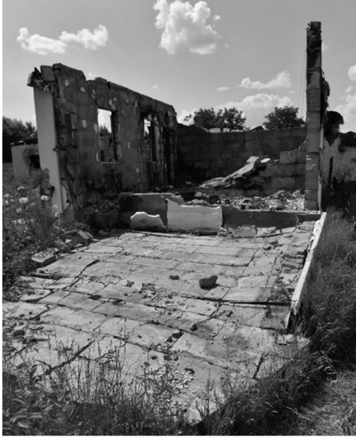
Рисунок 8 – Порушення технології зведення – відсутність монолітного поясу, неналежний напуск блоків, відсутність армування кладки
