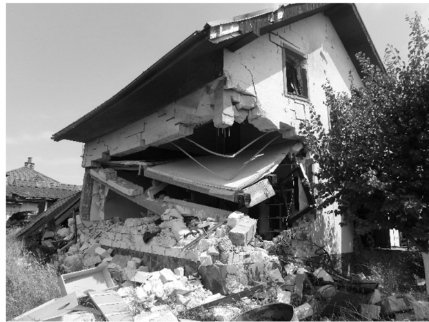
Рисунок 6 – Обвалення частини будинку, стіни якого з блоків з ніздрюватого бетону, внаслідок ударної дії прямого влучання снаряда
