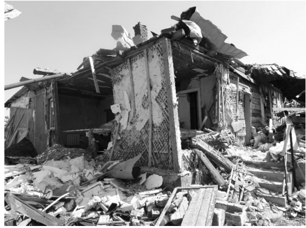
Рисунок 1 – Наслідок руйнування каркасного дерев'яного будинку внаслідок дії вибухової хвилі
