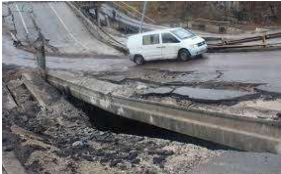
Рисунок 3 – Зруйнований міст на Чернігівщині
