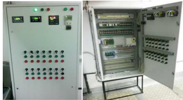
Рис. 1. Апаратні засоби АСУ науково-дослідним вентиляційним обладнанням
